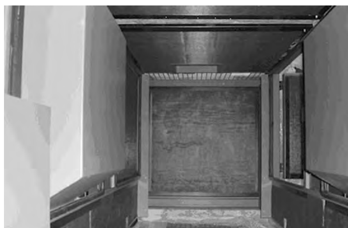
Imagen 3 - INTERIOR DE UN GRUPO ELECTRÓGENO INSONORIZADO
